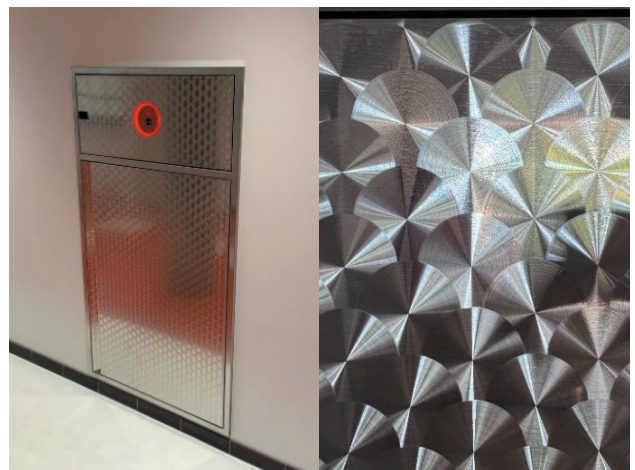
写真7 今回設置の屋内消火栓（右：うろこ模様拡大）
