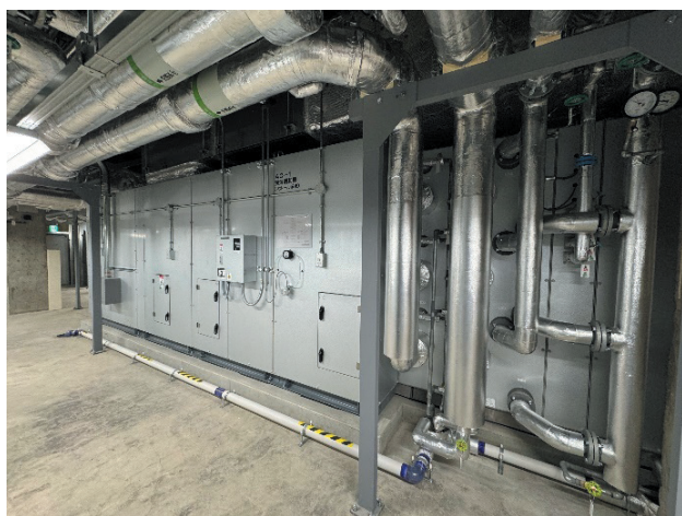
写真3 B2階設置空調機（AHU-1：大ホール系統）
